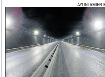
Las nuevas luces del túnel.
